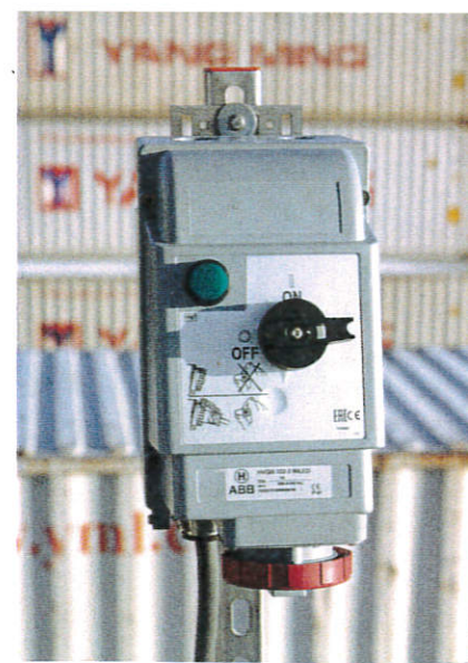
KJØLING. Stikkontakt for tilkobling av kjølecontainerne
